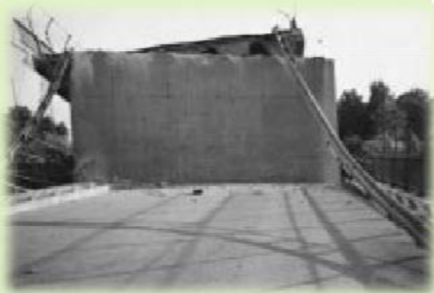
高架道路の被害
